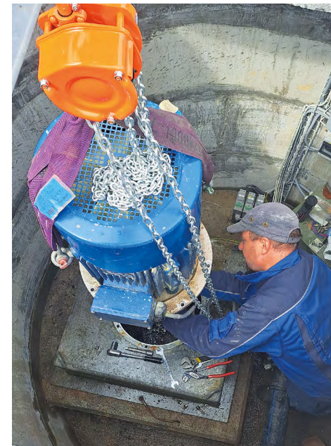
Kontrolle der Turbine
